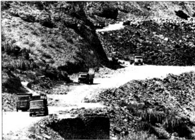
En las inmediaciones de la desembocadura del barranco de Veneguera, se trabaja en la carretera que unirá esta futura zona turística con Puerto de Mogán
